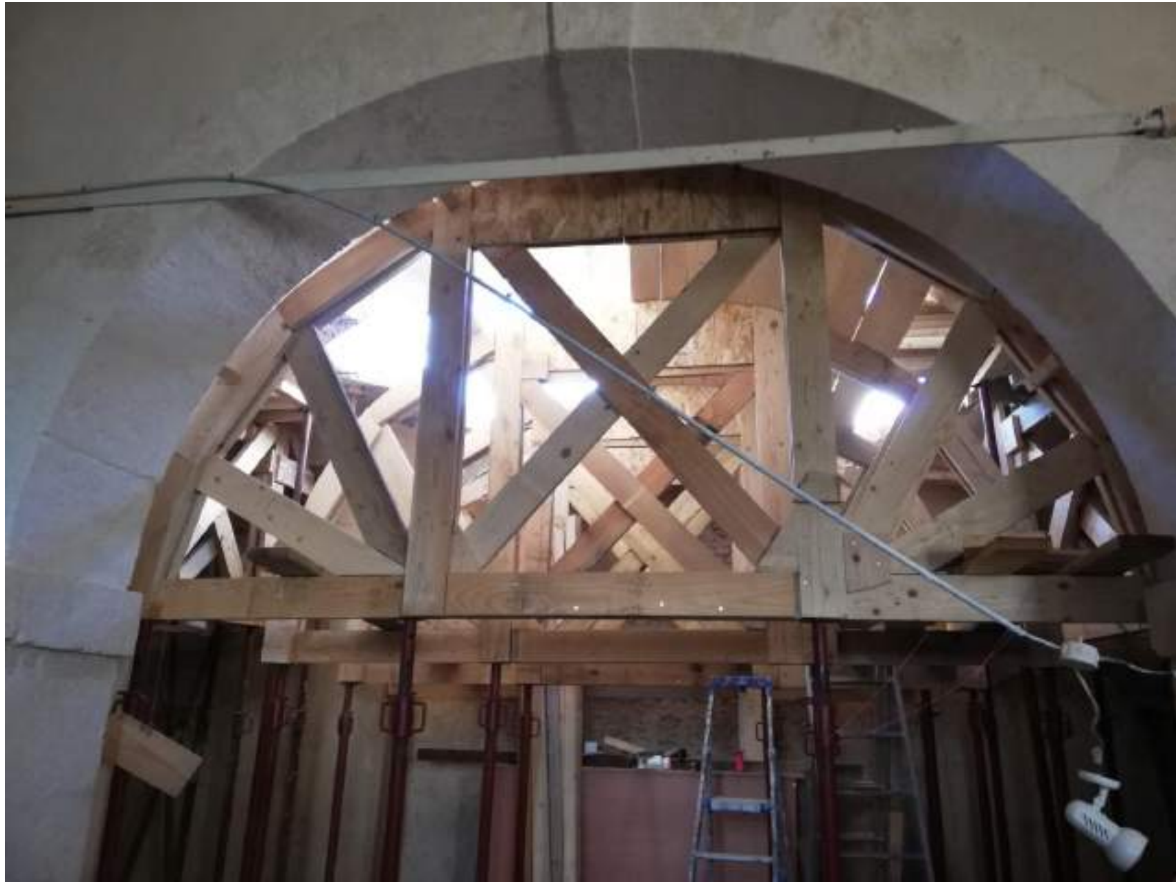
Mise en place des cintres en vue du remontage de la voute d'arêtes
