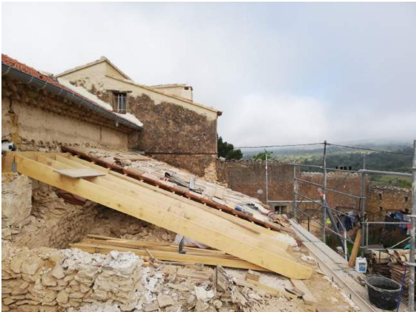
Réfection de la couverture du bas coté au dessus de la voute
