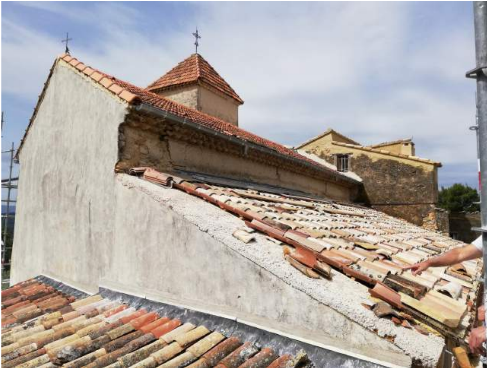
La couverture du bas coté quasiment terminée, la couverture de la nef a été intégralement reprise.
